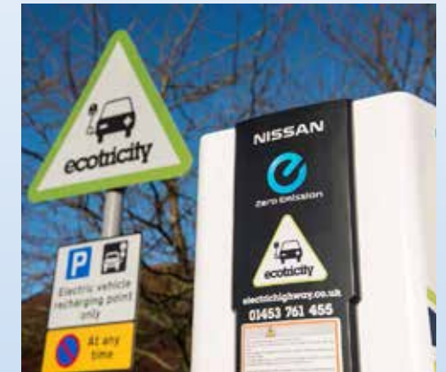
日产在欧洲安装的第 1000 台 CHAdeMO 快速充电器
